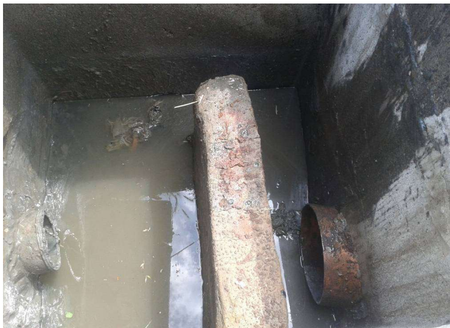
VISTA INTERNA CAMERETTA SMORZAMENTO
