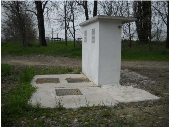
IMPIANTO CON NICCHIA CONTATORI IN MURATURA
