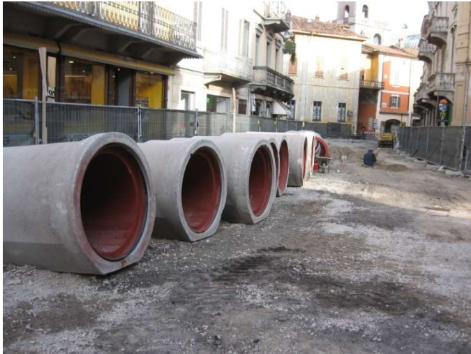
CONDOTTA CON RIVESTIMENTO IN GRES.
